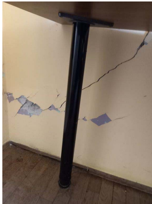
Pukotina u prizemlju
