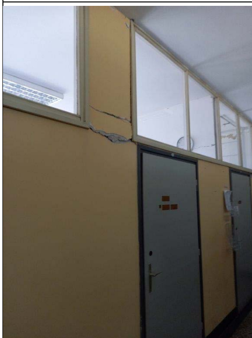
Oštećenja na katu
