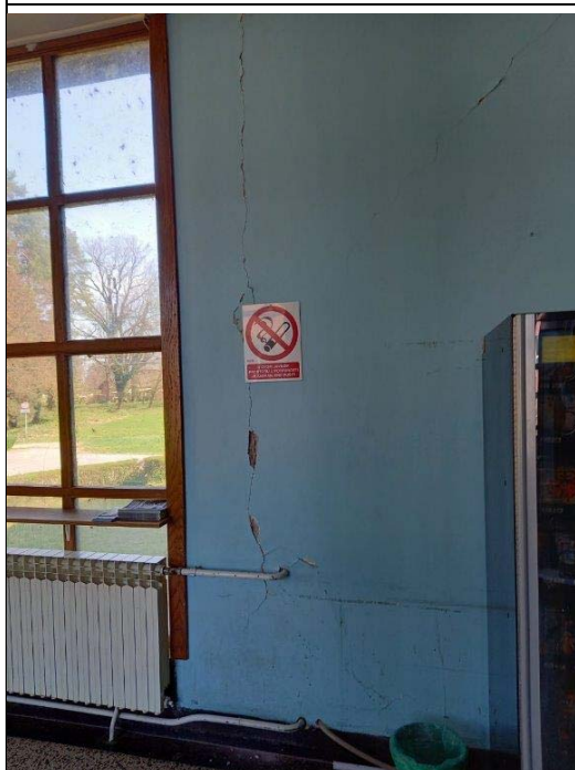
Pukotina u prizemlju
