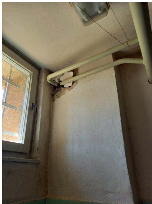
Oštećenja u podrumu
