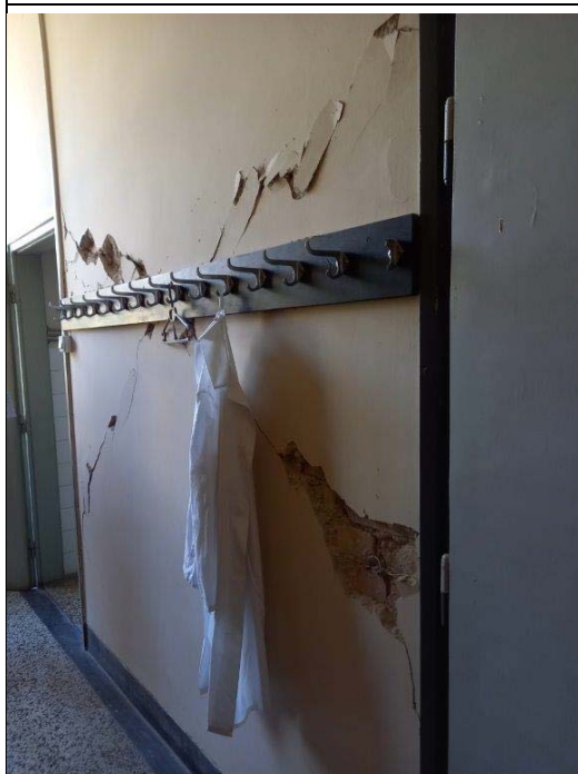
Oštećenja u prizemlju
