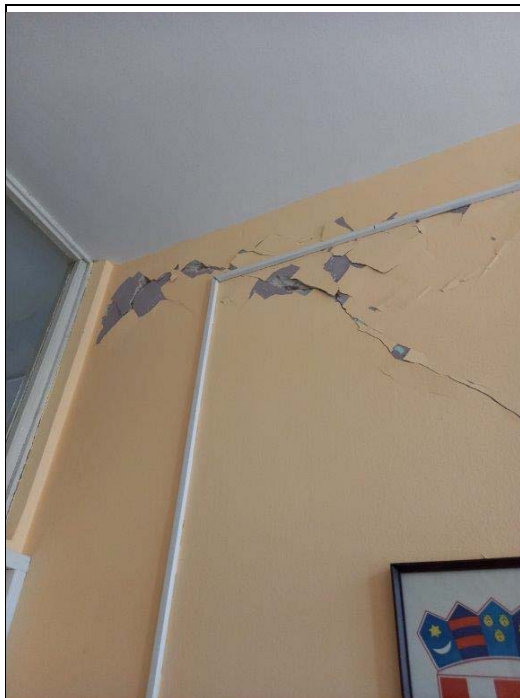
Pukotina u prizemlju
