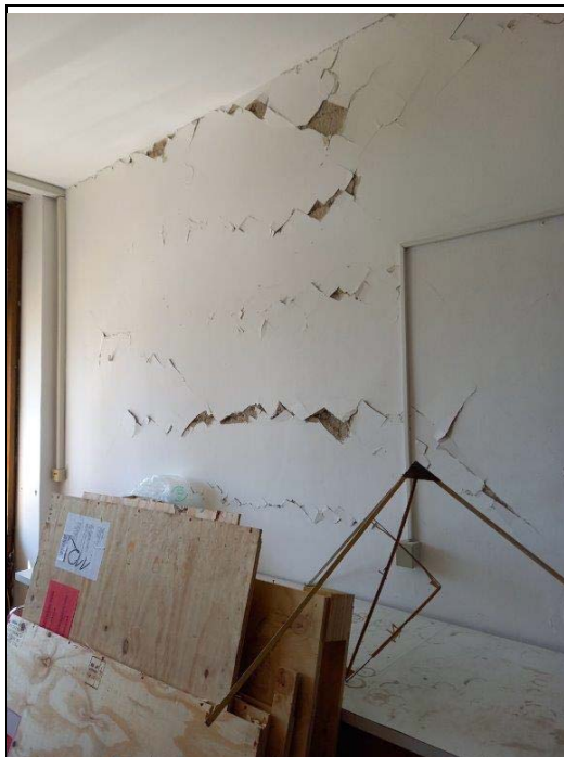
Oštećenja u prizemlju
