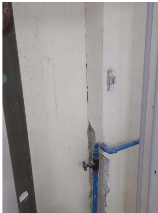
Oštećenja u prizemlju
