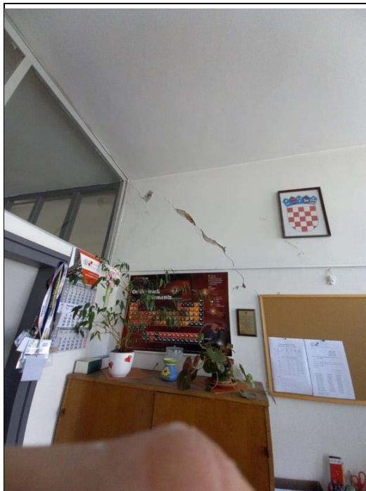
Oštećenja u prizemlju
