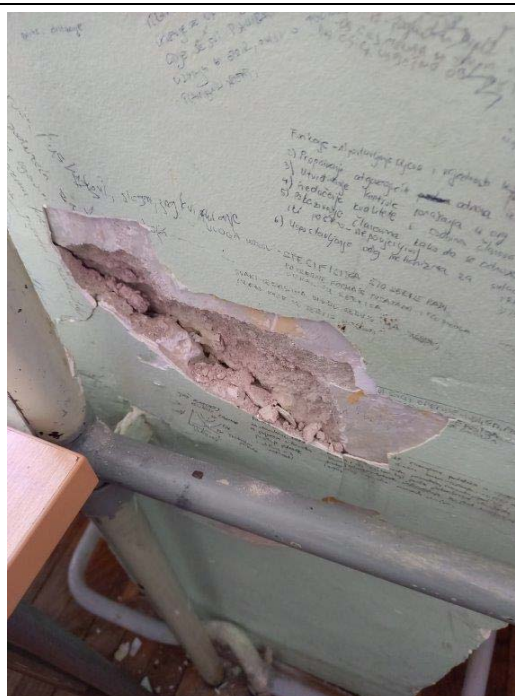
Oštećenje betonskog stupa na katu
