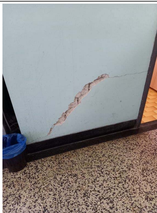
Pukotina u prizemlju
