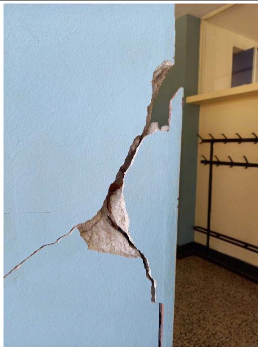
Oštećenje na pregradnom zidu kata
