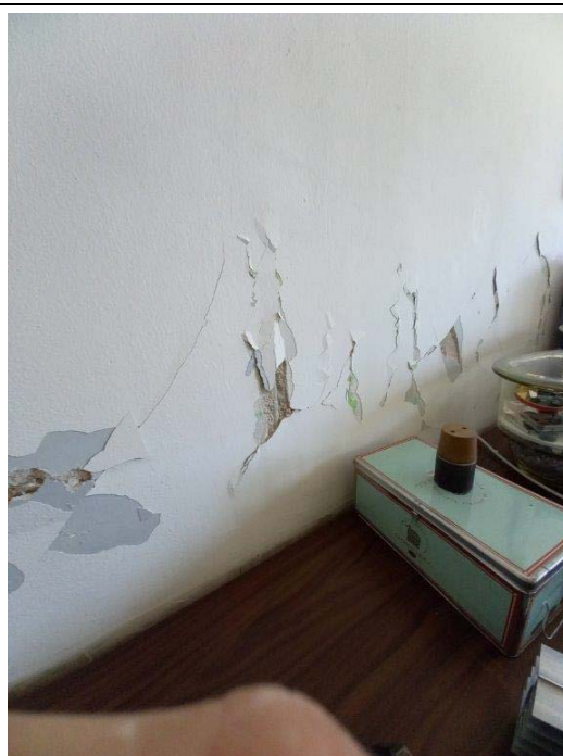
Oštećenja u prizemlju
