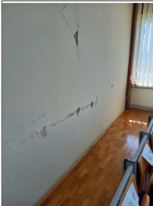
Oštećenja na katu
