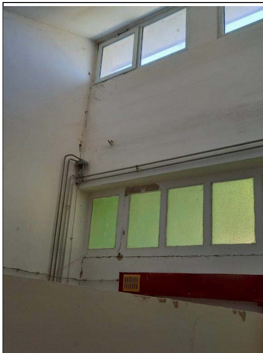
Oštećenja u prizemlju
