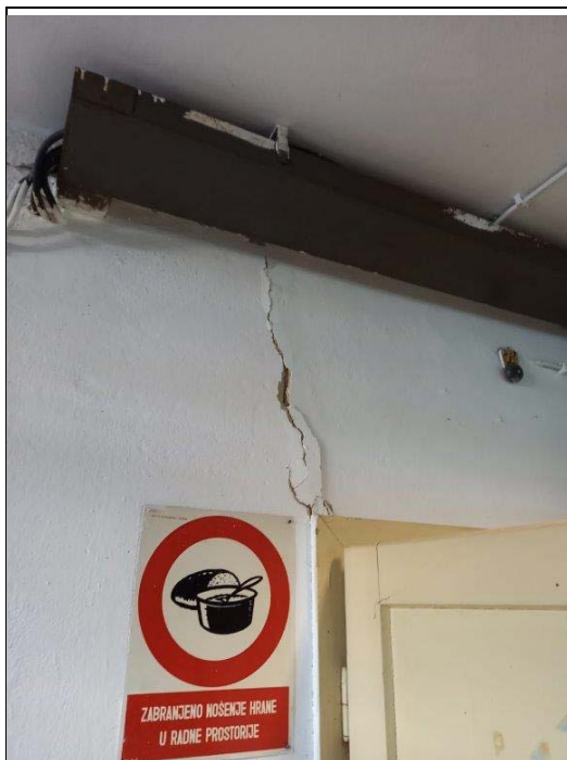
Pukotina u podrumu
