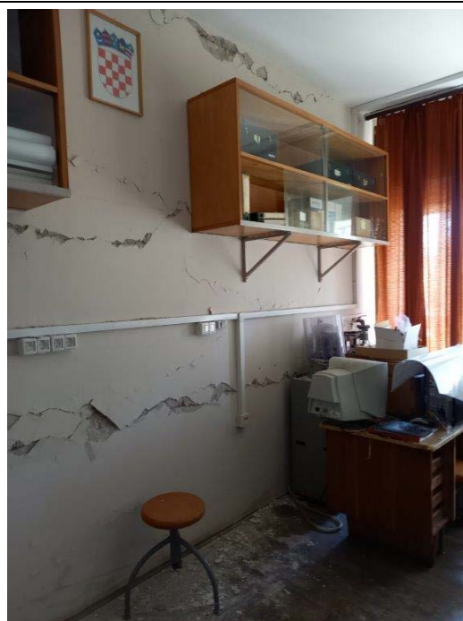
Oštećenja u prizemlju
