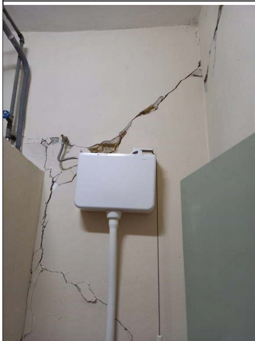
Pukotina u prizemlju
