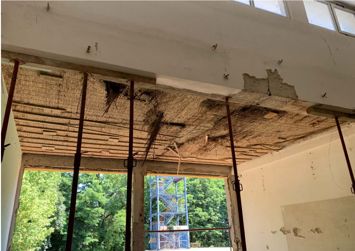
Slika 3 Prikaz oštećene stropne ploče i grede
